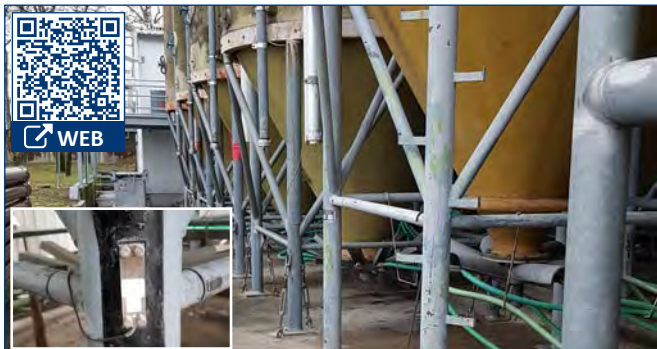
Siloverwiegung mit DMS-Messsystem
