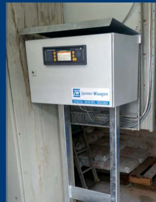
Auswertegerät im Schaltschrank mit Standfuß
