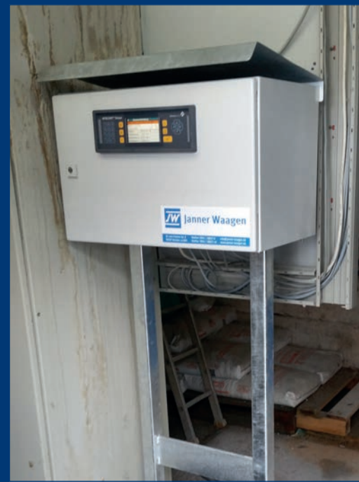
Auswertegerät im Schaltschrank mit Standfuß
